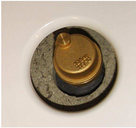
Рис.14. Спускной клапан на корпусе котла
