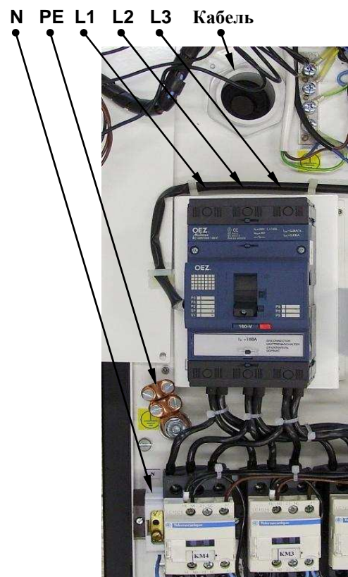
Рис. 21. Подключение входного кабеля котла «Daline PTE 22 – 60»
